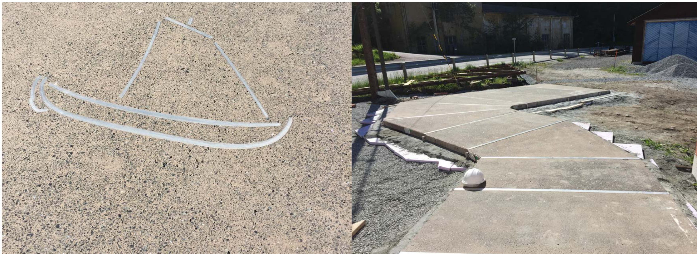
Frilagt profil av Geitbåt i aluminium koplet til armering av en støpelegering
